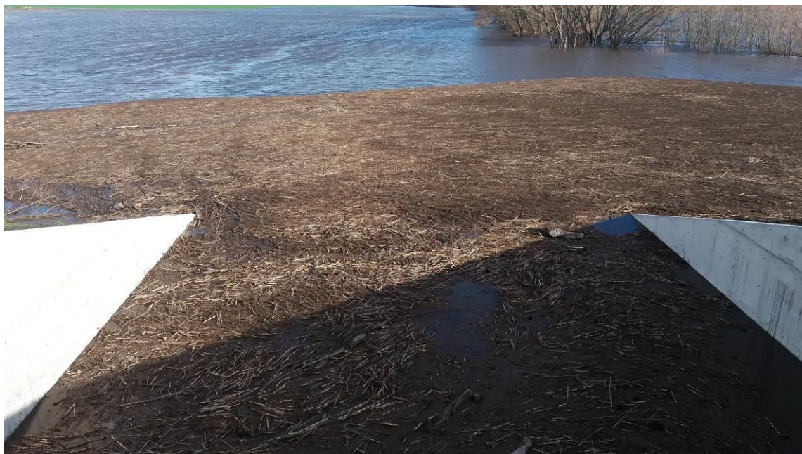
Figura 11. Material acumulado por el arrastre del arroyo en la entrada de los descargadores de fondo de la presa "La Isidora".
